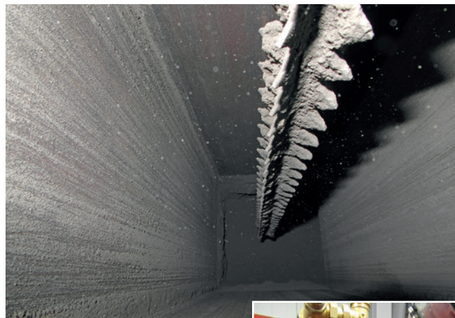
■ Innenansicht des neuen elektrostatischen Abscheiders.
