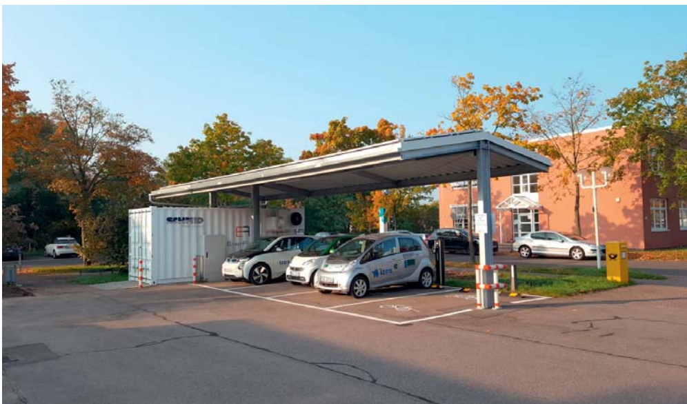
Bild 2: OptiCharge- Ladestation am Standort der IZES gGmbH in Saarbrücken. © IZES gGmbH
